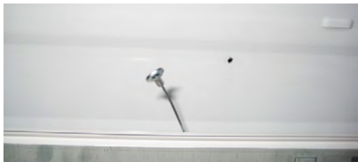
Picture G. Existing troffer
